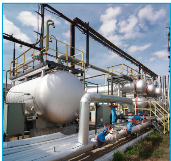
Перекачивание сжиженных углеводородов, пропана, бутана
